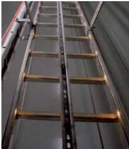
In die Steigleiter integrierte netzunabhängige Notbeleuchtung
